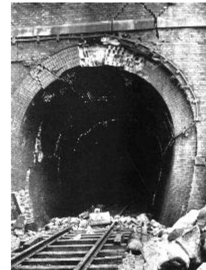
山線鐵路第8號隧道嚴重受損， 屯仔腳地震斷層穿越此隧道
